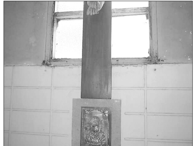
Ventana totalmente deteriorada detrás del altar de la iglesia La Milagrosa, cuyo estado es deplorable.
